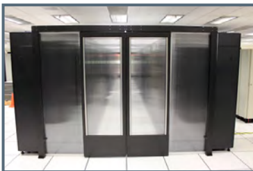
Aisle End Sliding Doors
